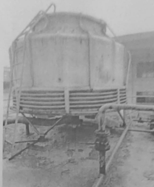
现有 200t 凉水塔
