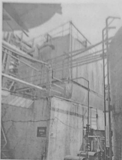
现有 400t/h 凉水塔
